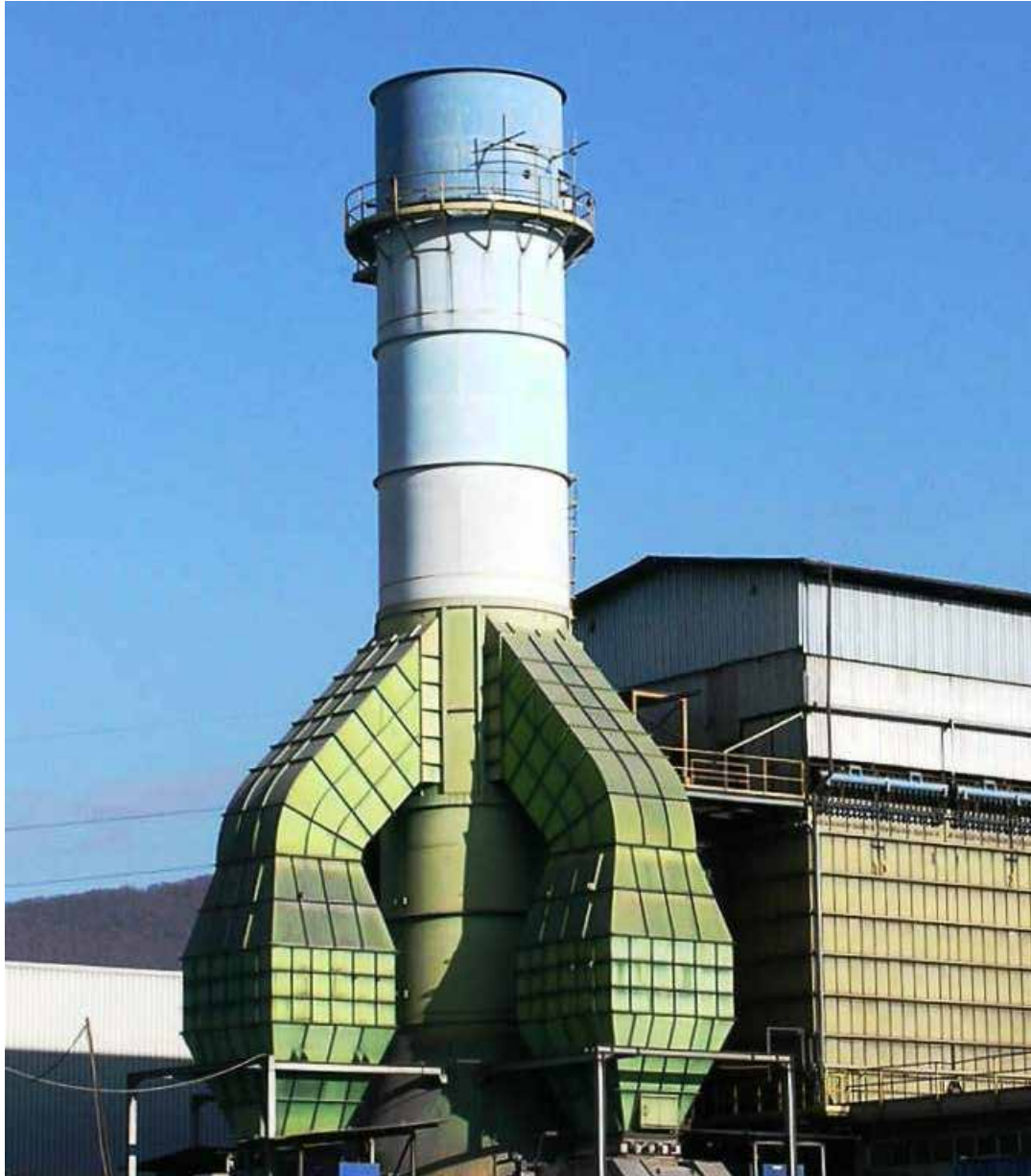
Vista dell'emissione E2
