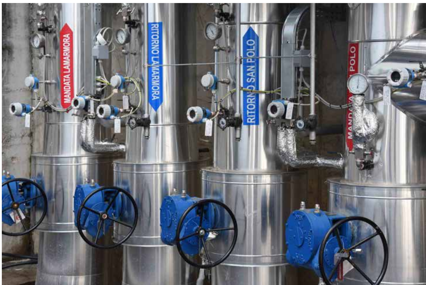
Particolare dell'impianto recupero calore
