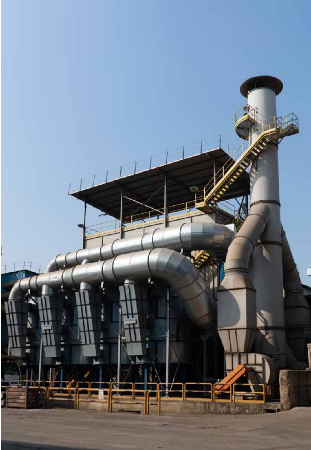
Vista dell'emissione E9
