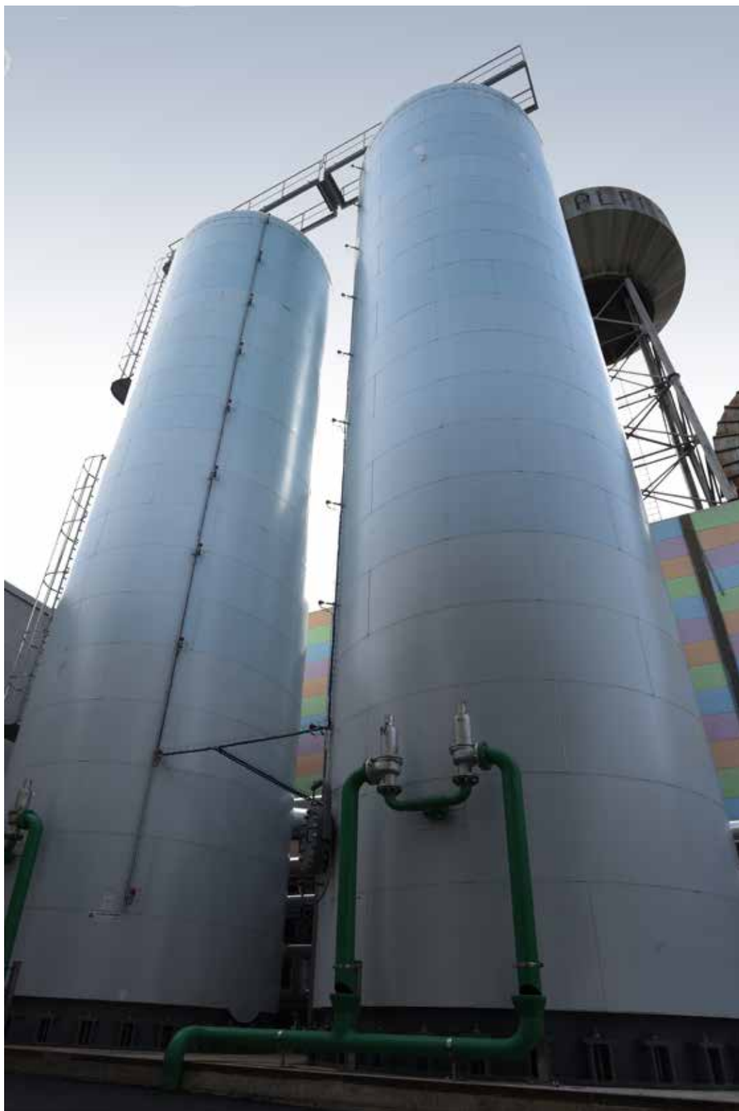
Serbatoi di accumulo acqua a servizio dell'impianto di recupero calore
