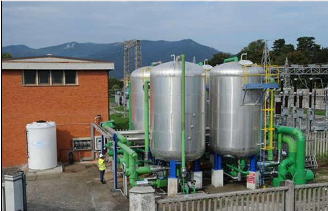
Figura 152: Vista parziale dell'impianto Nord acquedotto comunale
