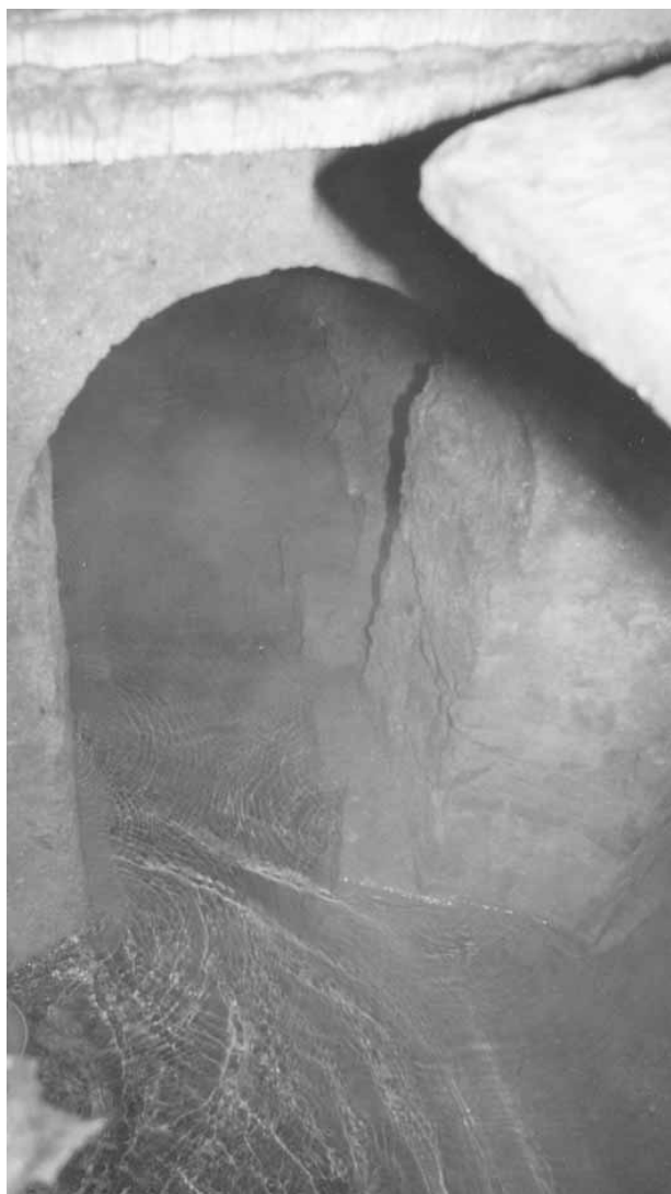
Comune di Capriolo: Pozzo San Lorenzo, interno del pozzo d'accesso (st. n° 161).
