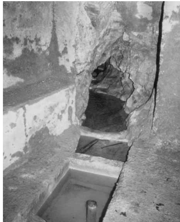
Captazione della sorgente carsica "Borniotti", vaschette di decantazione (st. n° 172).
