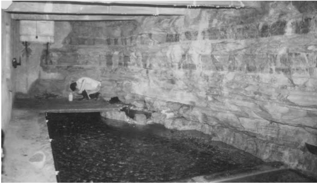
Captazione "Corno", vasca di decantazione (st. n° 179).
