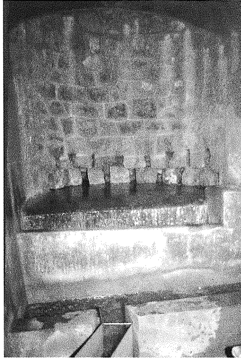
Foto 70 - Captazione “Sorgente Delizia” (Roncola Imagna, staz. n° 396 BG).
