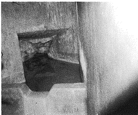
Foto 29 - Captazione "Tinelli 5", (Ponteranica, staz. n° 318 BG).
