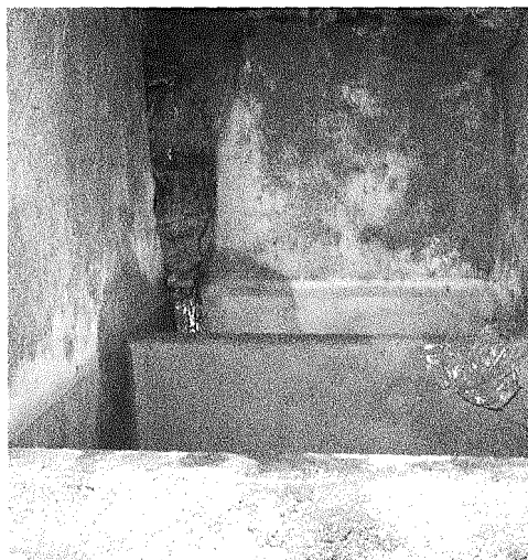
Foto 39 - Vecchia captazione in Val dei Mulini (Camerata Cornello, staz. n° 336 BG).
