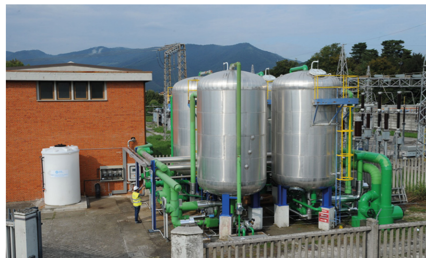
Figura 6 Vista parziale dell'impianto Nord
