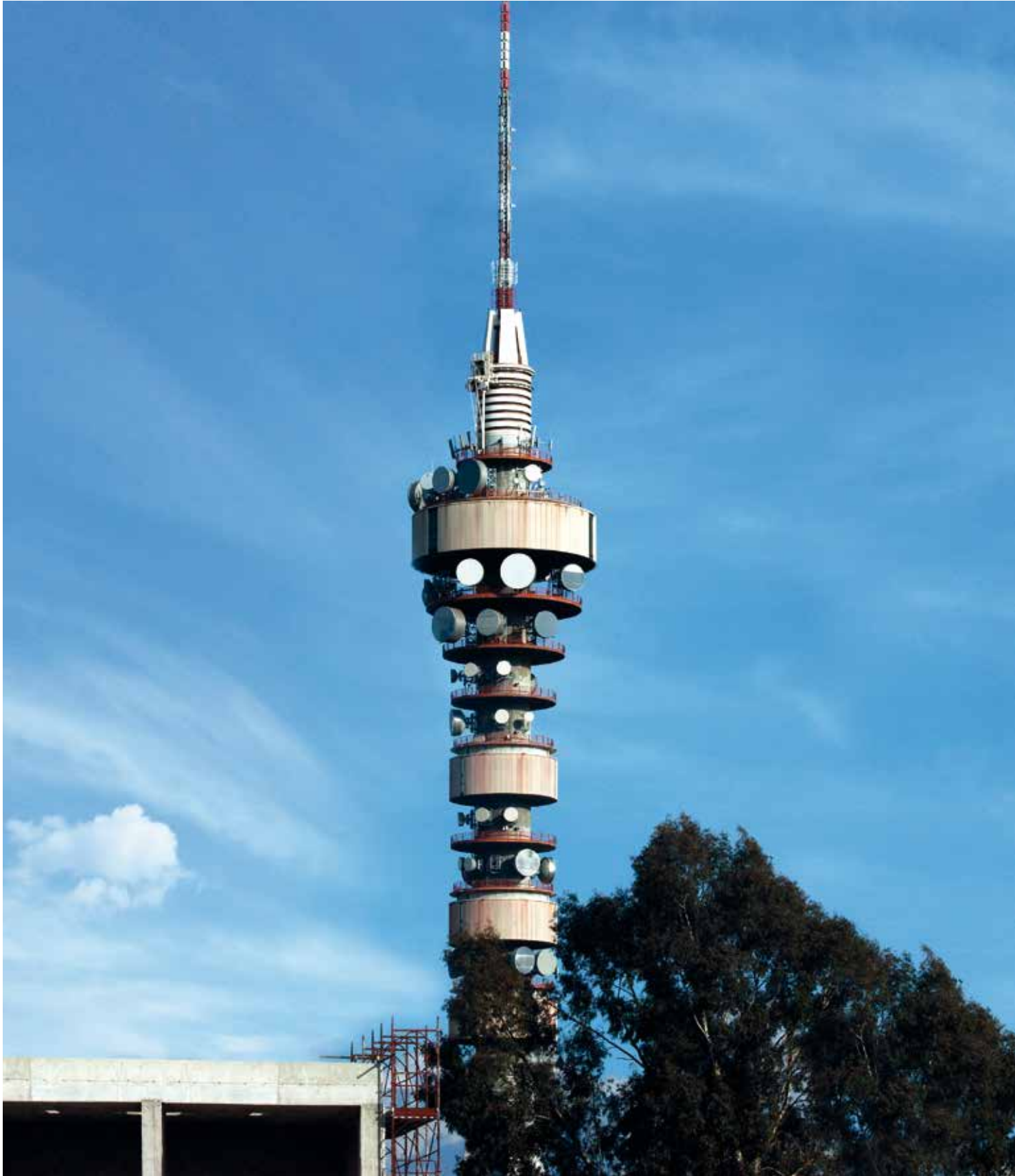
Foto 3.07 Antenna RTV Fonte ISPRA Paolo Orlandi
