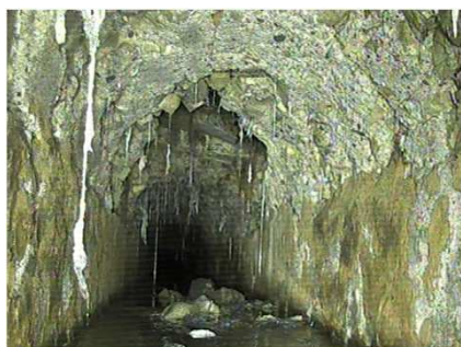
Rete in cunicolo – Piazzale Spedali Civili
