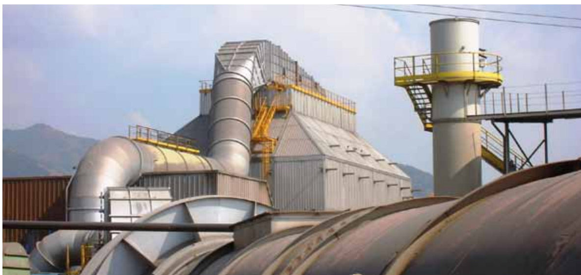
Impianti a presidio emissioni in aria (elephant house parte superiore)
