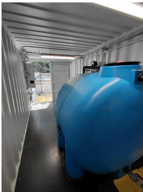
Figura 4: Impianto Soil Flushing
