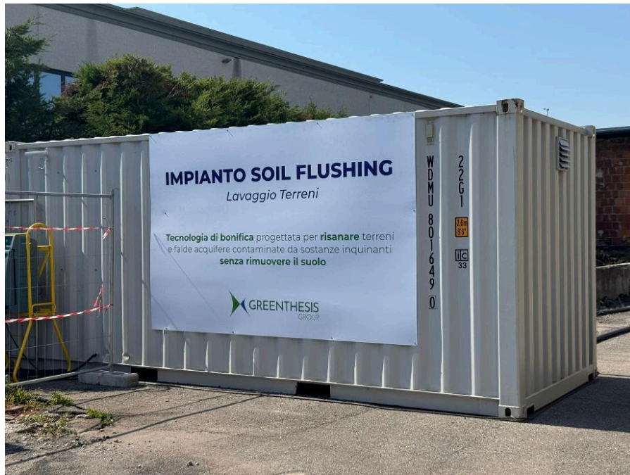
Figura 2: Impianto Soil Flushing
