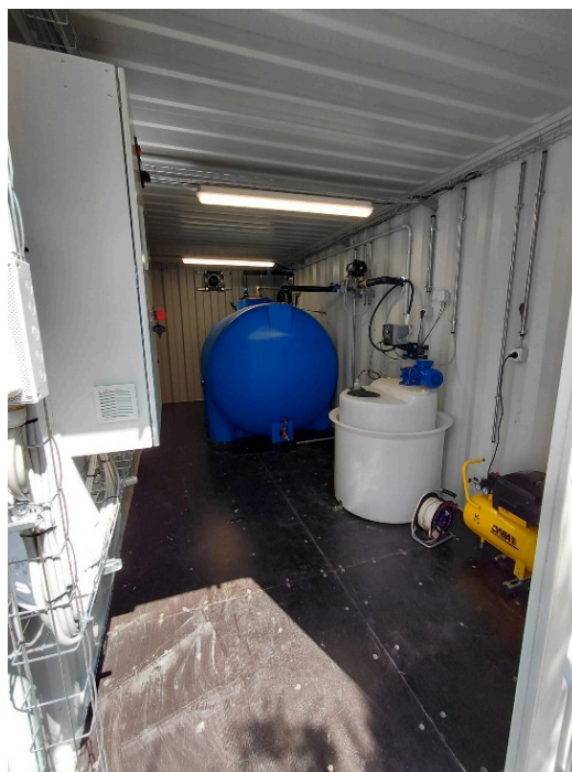
Figura 3: Impianto Soil Flushing
