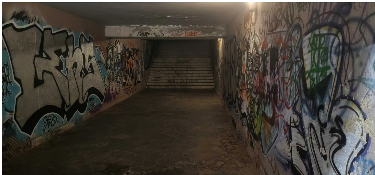
SOTTOPASSO ° ILLUMINATO CON VALORI MINIMI – 1 PLAFONIERA VANDALIZZATA
